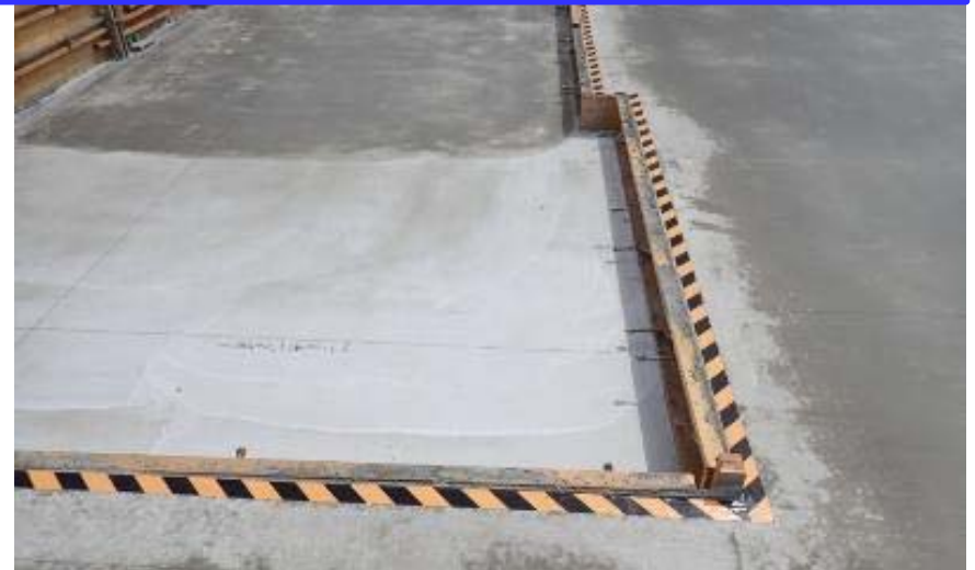
スラブ段差部分の注意表示
