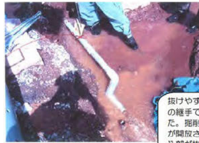
給水管損傷状況
