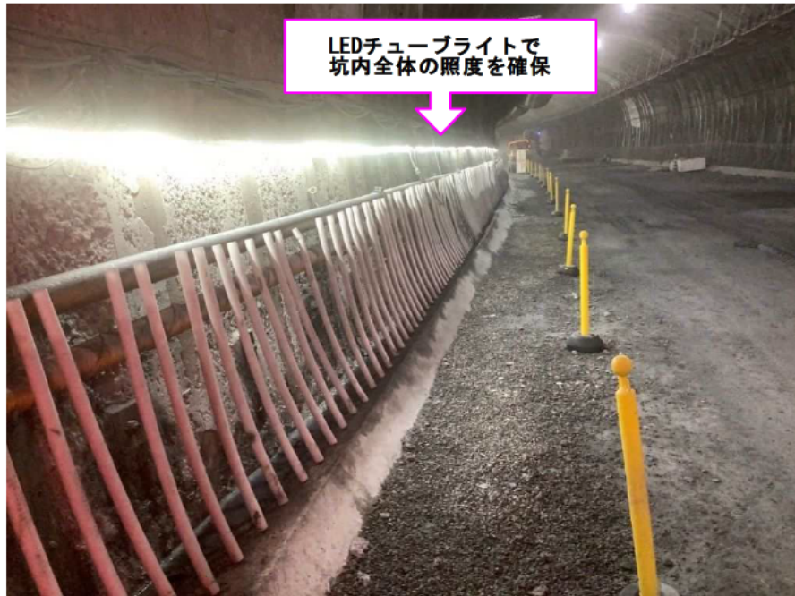
安全通路LED (あり)
