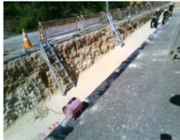
送風機配置による作業環境改善.JPG
