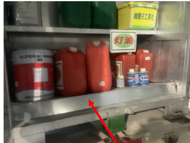
保管庫の奥に向けて勾配を取った棚板 (鋼板製)
