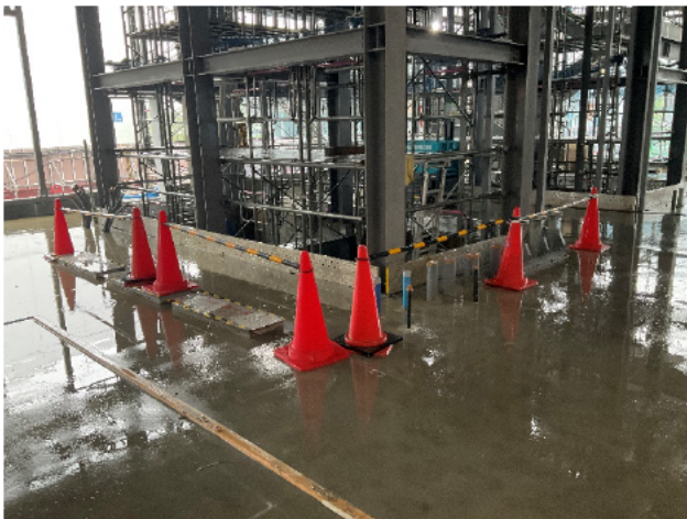
赤:床スリーブ突き出し転倒防止
