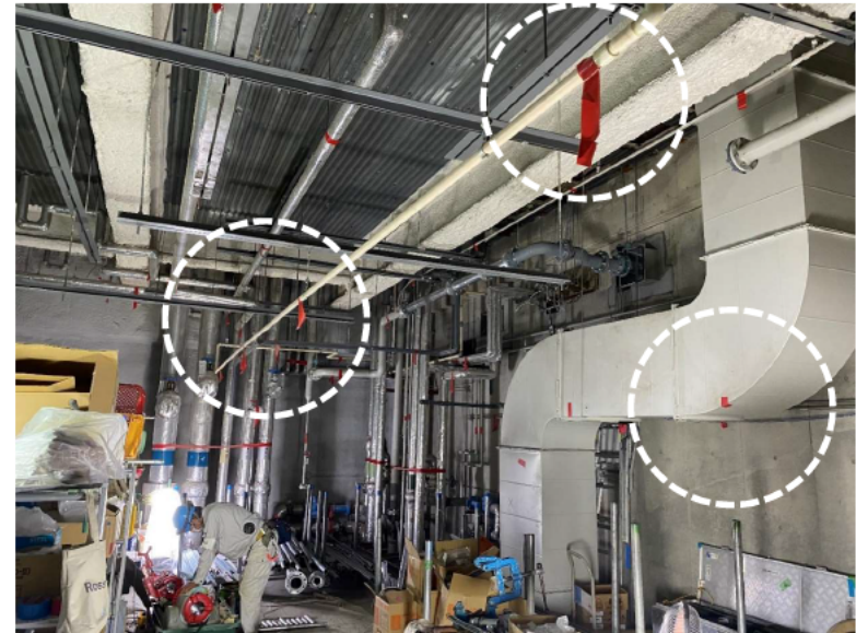
識別テープ表示状況
