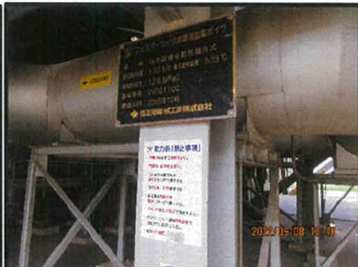
2号ボイラー1FL
