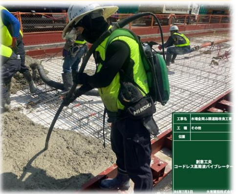
道路上の1車線内作業で発生する躓き事故対策としてコードレス機材の使用
