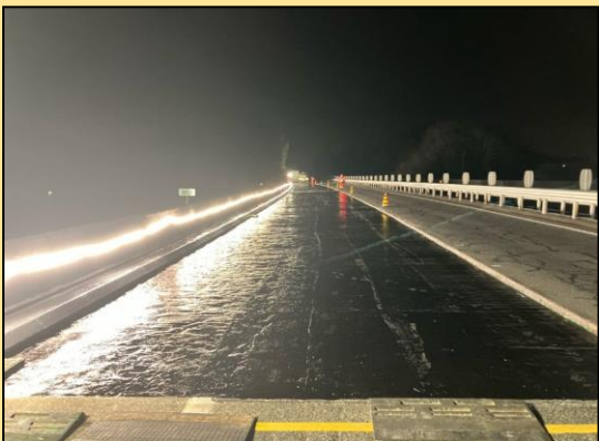
LEDテープライトによる 施工箇所の視認性確保
